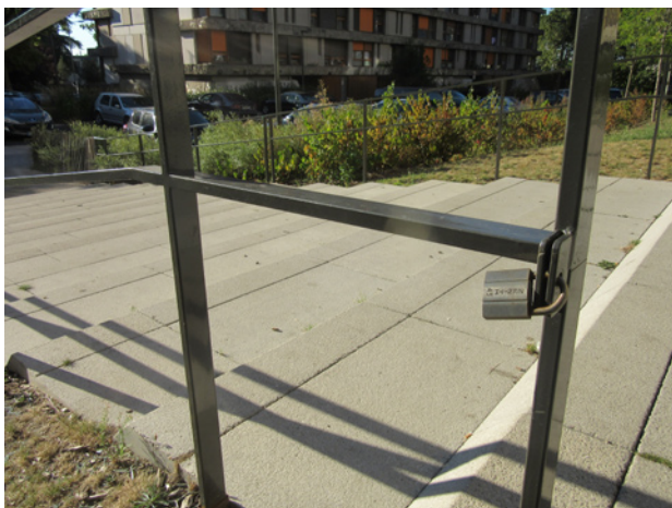
Rampe d'accès pompier avec garde-corps escamotable
