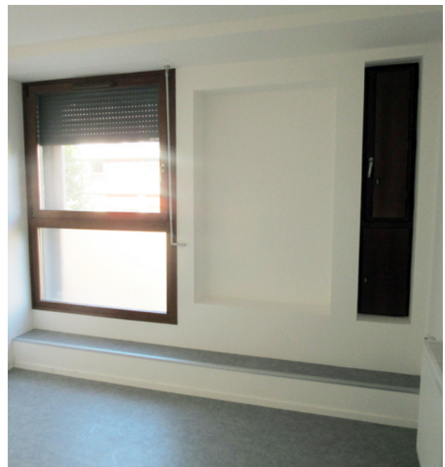
Banquette après réhabilitation servant de coffre de volets roulants pour les chambres des appartements du dessous
